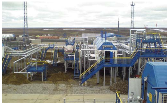
Рис. 3. Блок подготовки газа (по центру, в блок-боксе)
