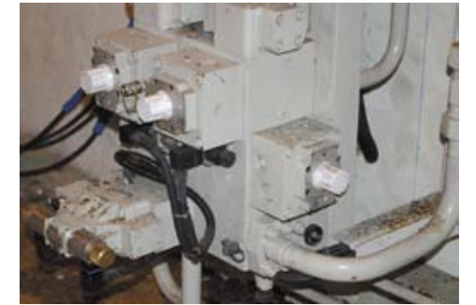
Рис. 4. Стенд с элементами гидросистемы для управления затвором
